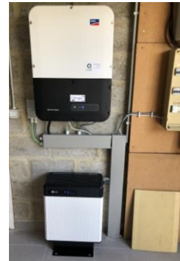
Omvormer (boven) en de LG RSU10 thuisbatterij (onder) (Q-Home).
