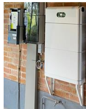
Huawei-omvormer en -thuisbatterijen (10 kWh) (MR Solar)
